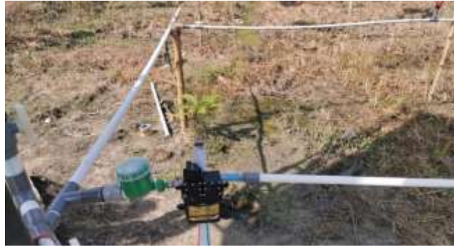
Gambar 14. Instalasi Timer dan Pompa Air
