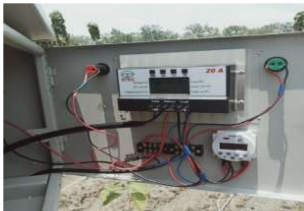
Gambar 11. Instalasi Listrik pada Panel
