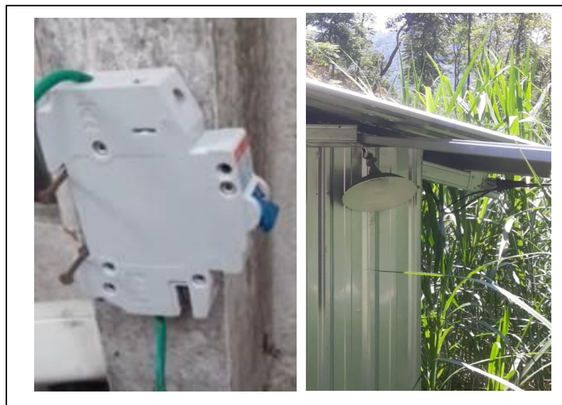
Gambar 1. Kondisi instalasi listrik yang kurang sesuai dan tidak aman
