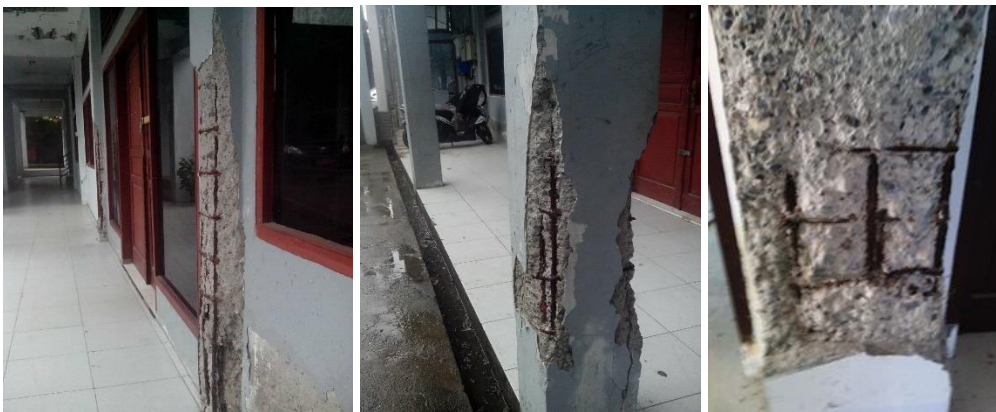
Gambar 3. Dokumentasi Dampak Tsunami Pada Struktur Gedung Laboratorium Dinas Pekerjaan Umum, Kota Banda Aceh
