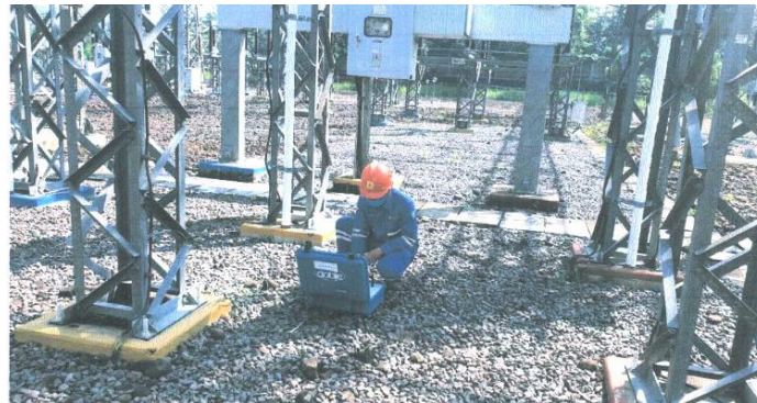
Gambar 3. Pegujian LCM pada LA di Gardu Induk Saketi 150KV Sumber: PT. PLN ULTG Rangkasbitung
