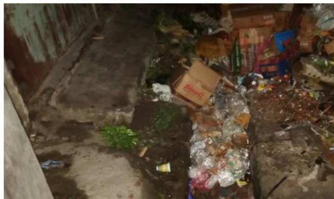
Gambar 1.8 Sampah didalam gedung lantai 1
